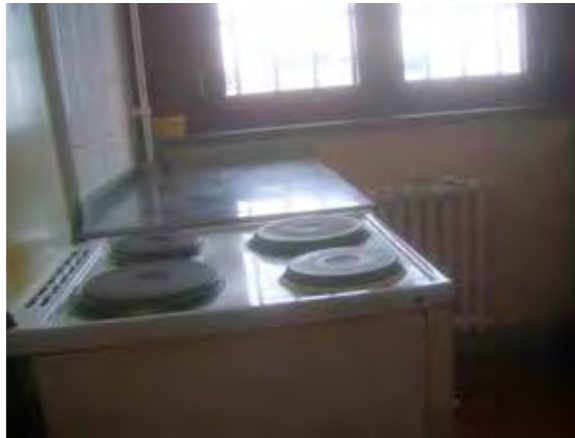
▲ Stationsküche in der Teilanstalt VI mit nur einem Herd ohne ausreichende Arbeitsflächen mit Doppelspülbecken und Boiler
